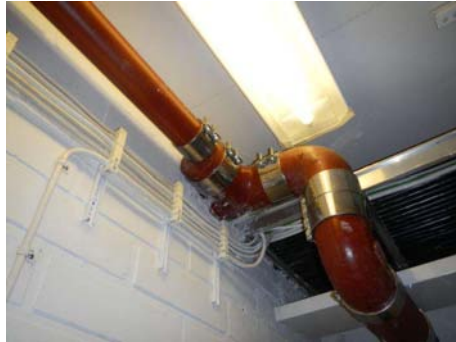
Viemäriässä on jyrkkiä kulmaosia ja muuntoyhde on väärässä asennossa.
