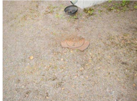
Kaivojen kansirakenteet ovat paikoin lohkeilleet.
