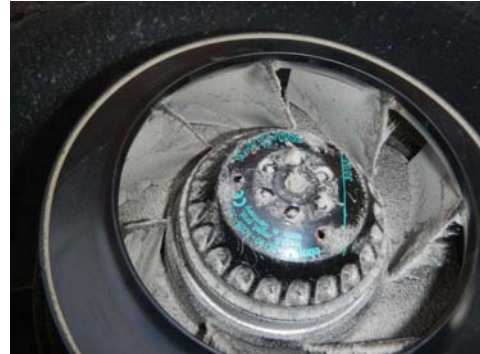
Puhaltimen siivissä on epäpuhtauksia.
