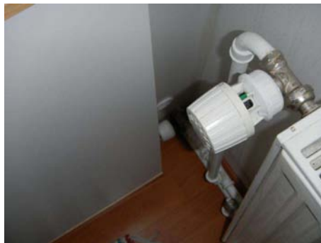
Yleiskuva lämpöpatterista ja patteriventtiilistä sekä keittiön alasokkelin putkikiepille menevistä
