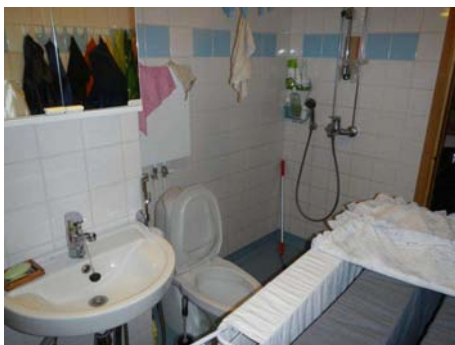
Yleiskuva vesi- ja viemärikalusteista.
