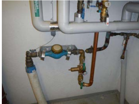
Yleiskuva vesimittarista ja pääsuluista.
