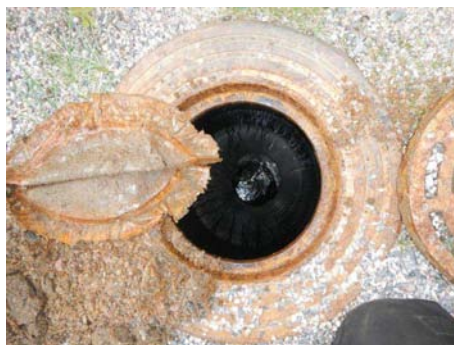
SVK-kaivon ritiläkannen alle on laitettu muovikalvo. Muovikalvo tulee poistaa.
