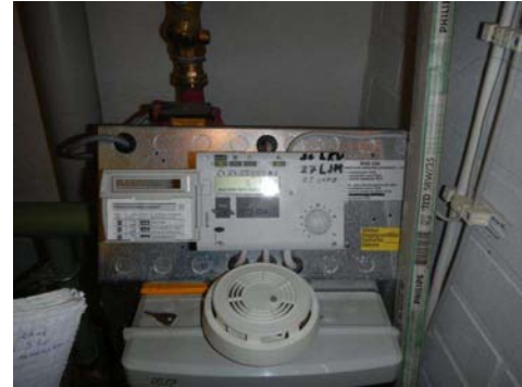
Yleiskuva lämmönjaon säätökeskuksesta.
