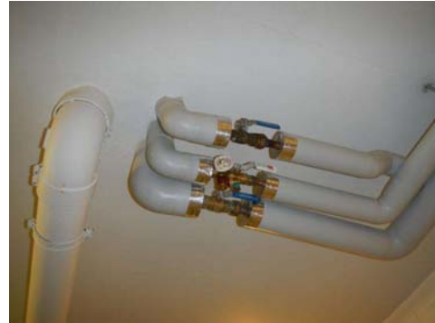
LVK-säätöventtiilit ovat täysin auki.
