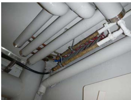
Lämpöverkostossa on käytetty muoviputkiasennuksia.
